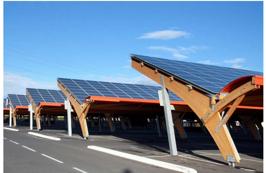
Photovoltaik-Anlagen auf dem Parkplatz
